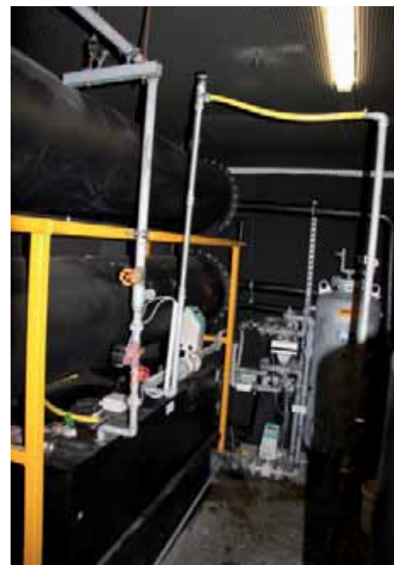
Blick auf die Horizontalstripanlage in der schallgedämmten Fertigarage
