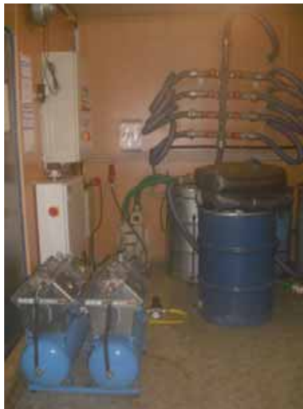
Innenansicht Air Sparging-Bodenluftabsauganlage
