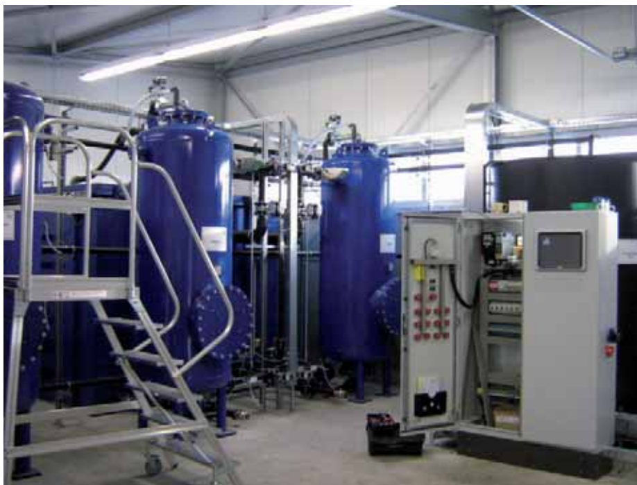
Blick in die neue Wasseraufbereitungsanlage
