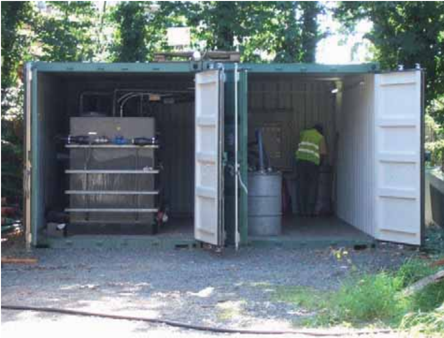
Grundwasseraufbereitungsanlage am neuen Standort westlich des FAGRO-Werks I
