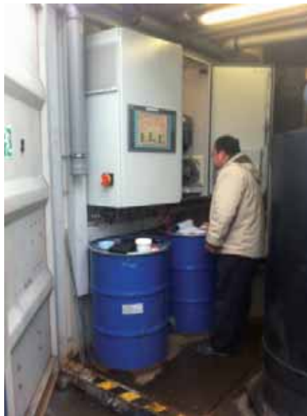
Kontrolle der Anlagensteuerung
