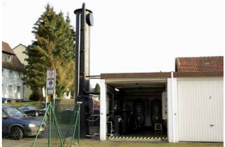
Blick auf die Grundwassersanierungsanlage
