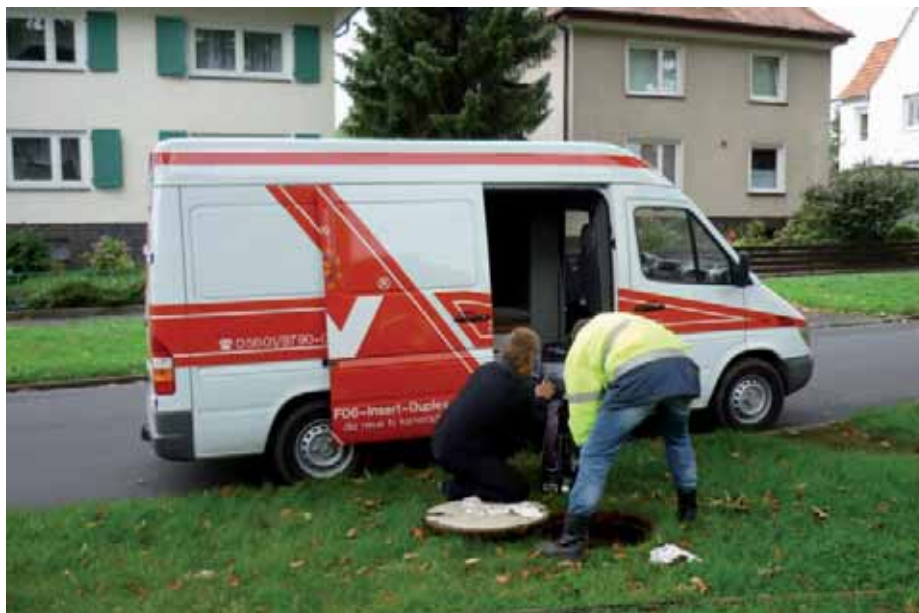
Kamerabefahrung an einem Sanierungsbrunnen in der Wilhelm-Busch-Straße
