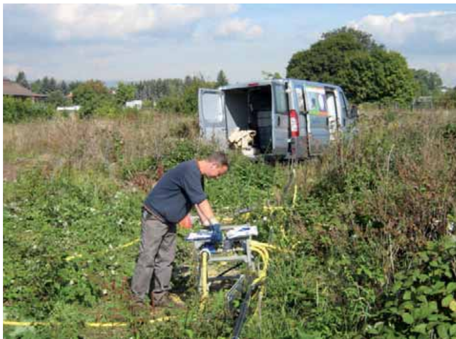
Durchführung des Feldversuches zum mikrobiologischen Abbau der LHKW-Belastung im Grundwasser
