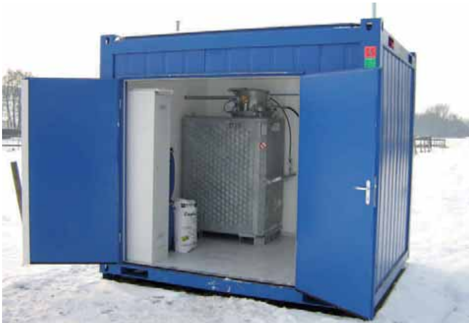
Blick in den Container der Teerölabsaugung mit Gefahrstofftank
