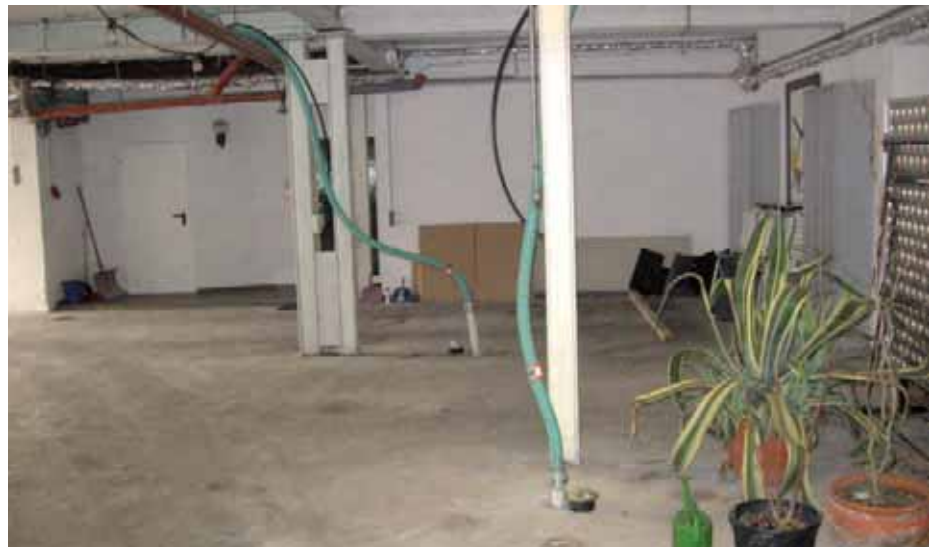
Absaugung von Bodenluft in den Innenräumen
