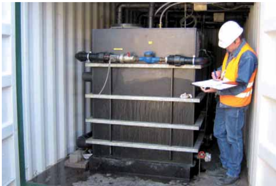
Anlagenkontrolle an der Grundwasseraufbereitungsanlage am ehemaligen FAGRO-Werk I (Sudetenstraße)
