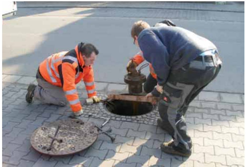
Revision am Sanierungsbrunnen
