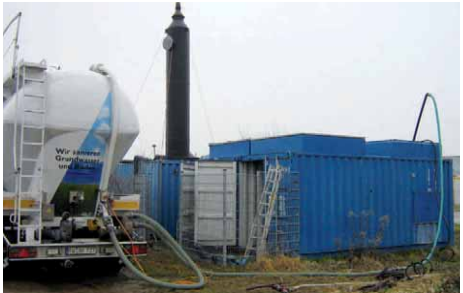
Aktivkohlewechsel an der Grundwassersanierungsanlage
