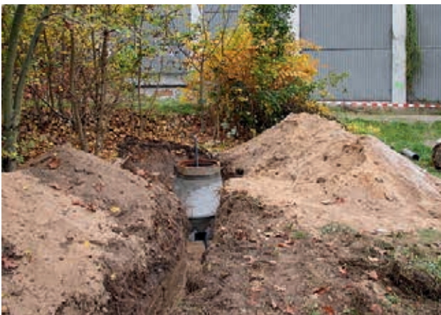
Anschluss des Sanierungsbrunnens SB 5
