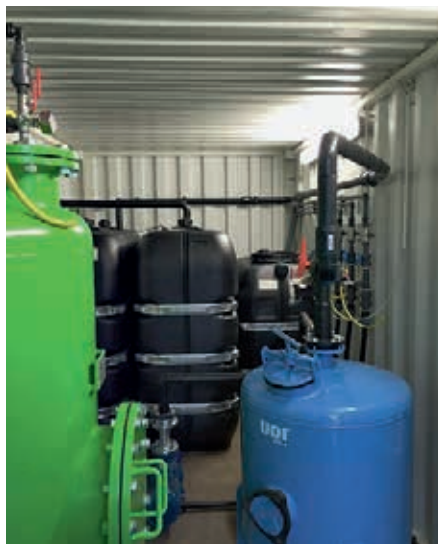
Blick in die neue Sanierungsanlage
