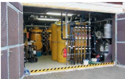
kombinierte Bodenluft-, Schicht- und Grundwasserreinigungsanlage
