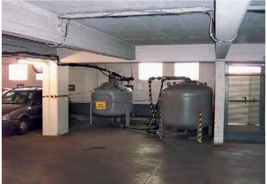
Blick auf die Sanierungsanlage im Untergeschoss
