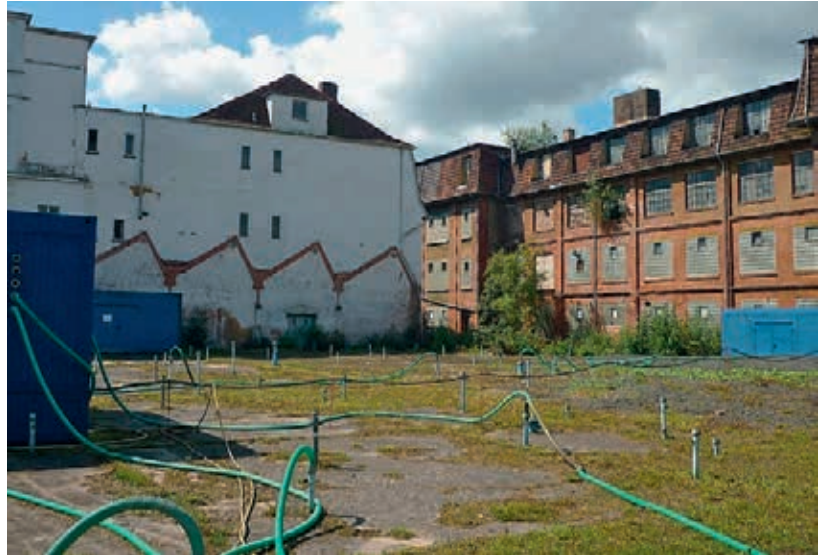
ehem. Betriebsgelände mit Bodenluftabsauganlage
