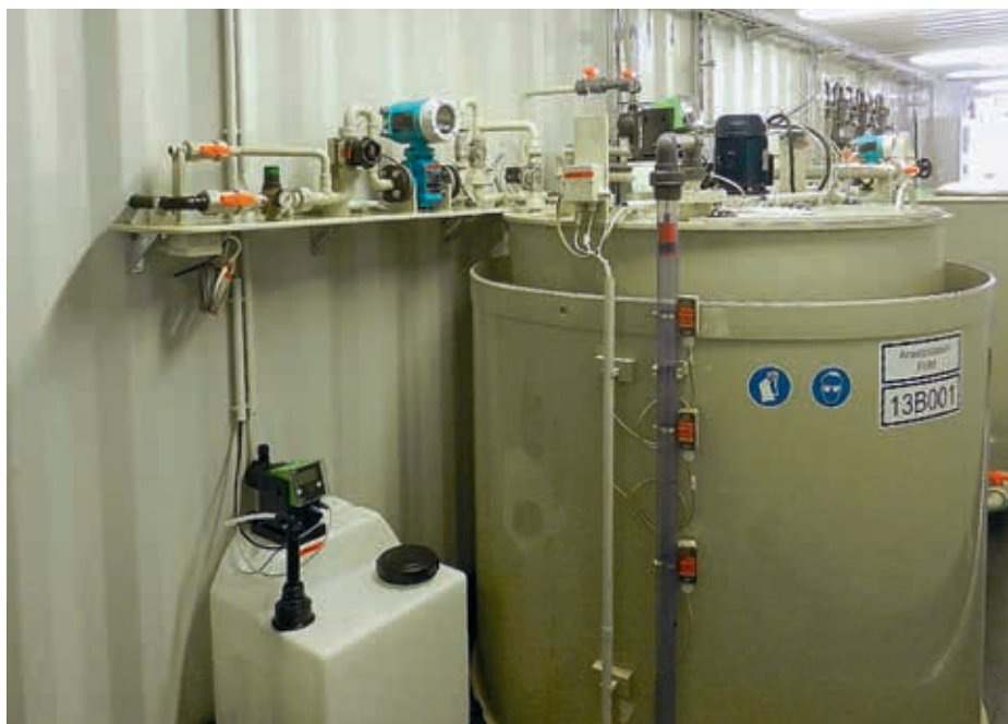
Abbildung 2: Blick in die Ansetz- und Dosieranlage
