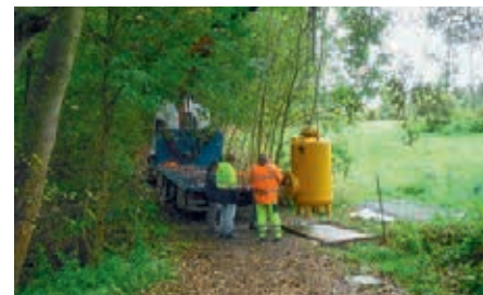
Einrichtung mobile Grundwasserreinigungsanlage für Langzeitpumpversuch
