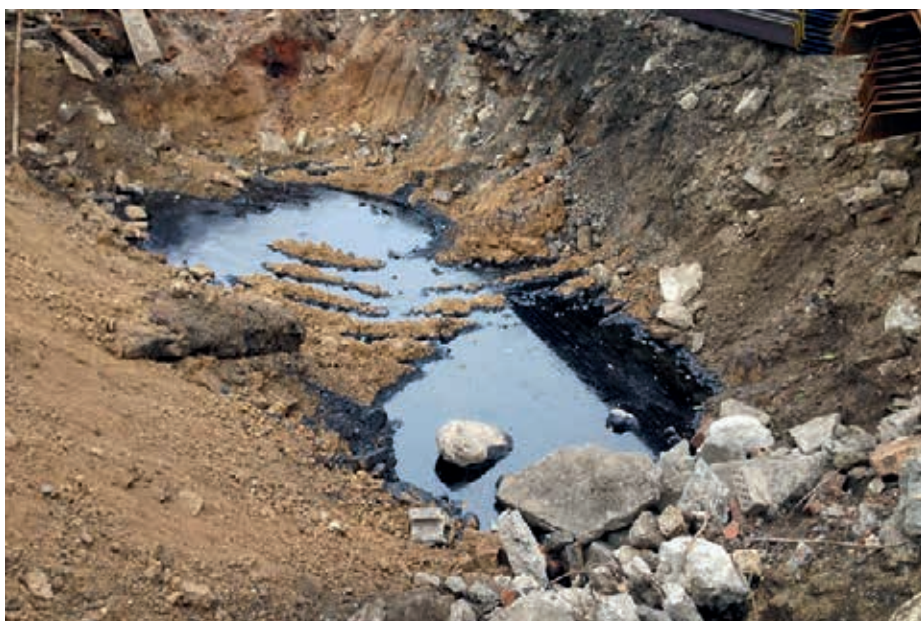
Teeröl in der Baugrube
