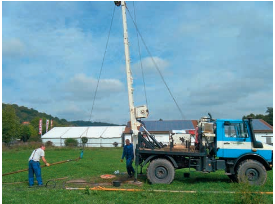
Wechsel Steigleitung und U-Pumpe am Sanierungsbrunnen
