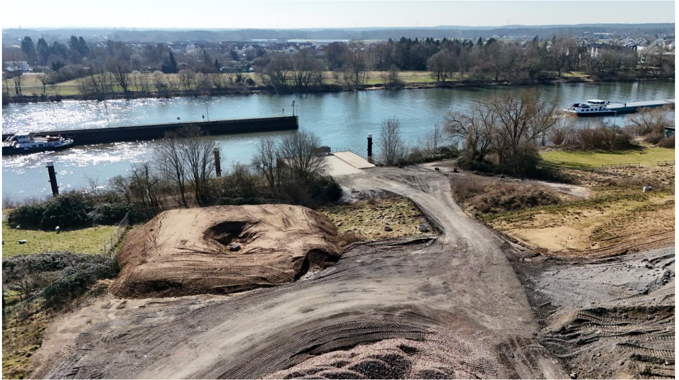
Abb. 3: Blick auf die Materialumschlaganlage am Main
