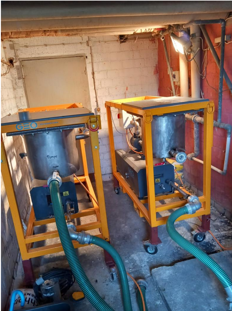
Vakuum-Verdichter in den ehem. Betriebsräumen
