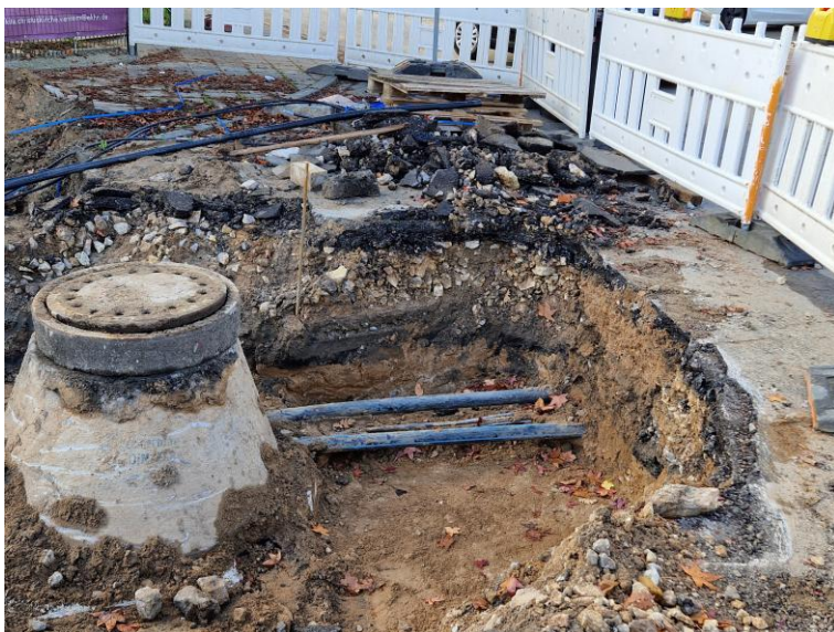
Revisionsschacht an der Ecke Saarlandstraße/Rheinstraße
