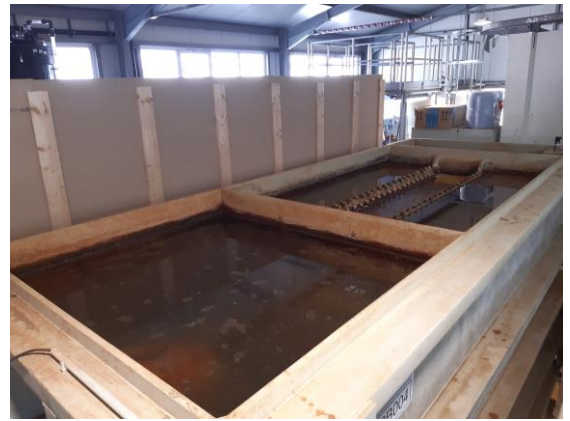
Wasseraufbereitungsanlage in Lampertheim-Neuschloß
