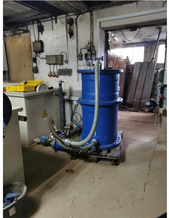
Ergänzender Wasseraktivkohlefilter für den Testbetrieb 2025
