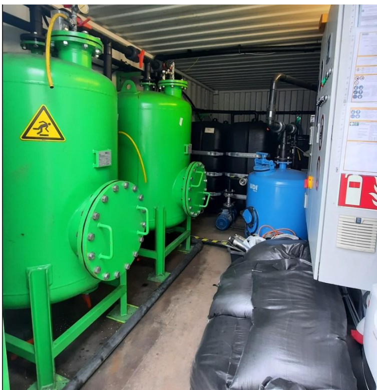
Grundwasserreinigungsanlage mit Wasseraktivkohlefiltern
