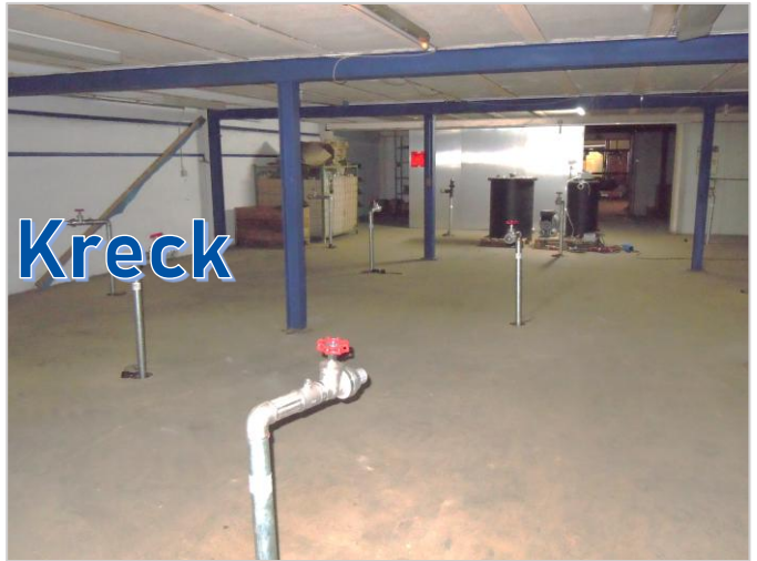
Neue Bodenluftpegel vor Beginn des Testbetriebs (Juli 2025)
