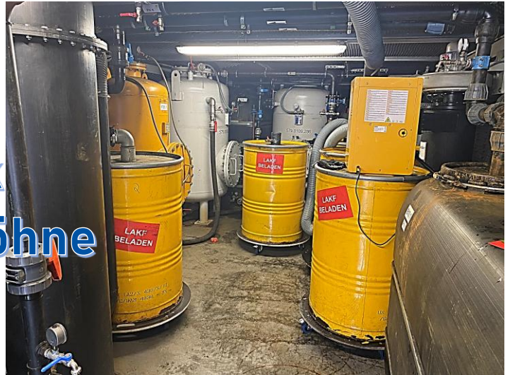
Innenansicht der Sanierungsanlage
