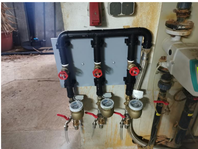
Sammelbalken und Wasseruhren für drei Test-Sanierungsbrunnen
