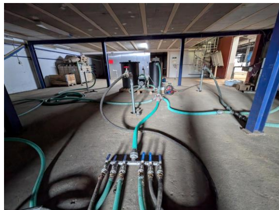
Bodenluftabsauganlage für den Testbetrieb
