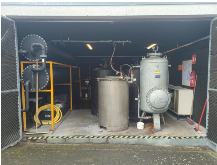
Grundwasserreinigungsanlage (Horizontal-Strippanlage mit 2-stufigem Wasser- und Luftaktivkohlefiltersystem)
