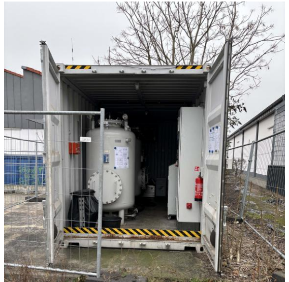
Anlage mit Sanierungsbrunnen
