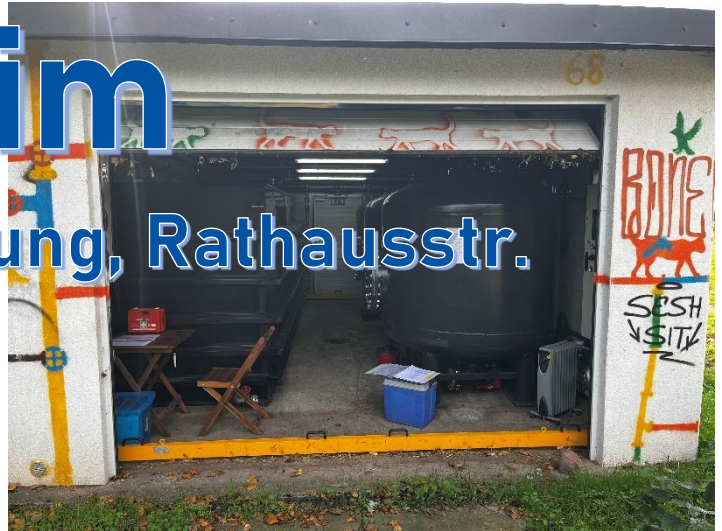
Wasseraufbereitungsanlage in einer Fertiggarage
