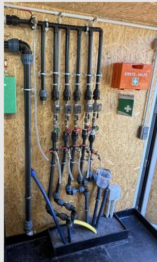
Probenahmestellen und Durchflussmesser
