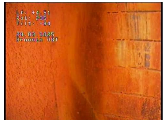
Kamerabefahrung des Brunnen Ost mit erkennbarer Verockerung
