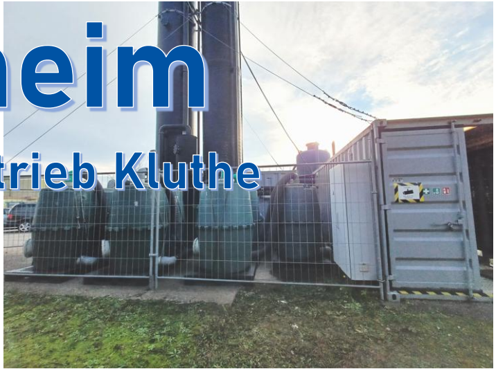
Grundwasserreinigungsanlage nach Umstellung auf eine zweistufige Luftaktivkohle-Adsorption
