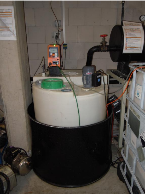
Dosierstation für Reduktionsmittel zur Chromat-Eliminierung
