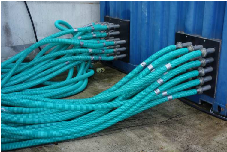
Anschluss der BL-Leitungen aus den Pegelfeldern an die Sanierungsanlage
