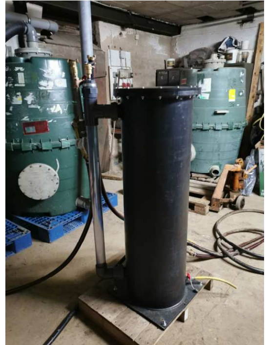
Schwerphasenabscheider für den Pumpversuch
