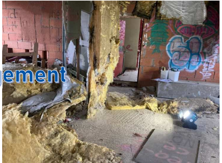
Vandalismus innerhalb der verbliebenen Gebäude
