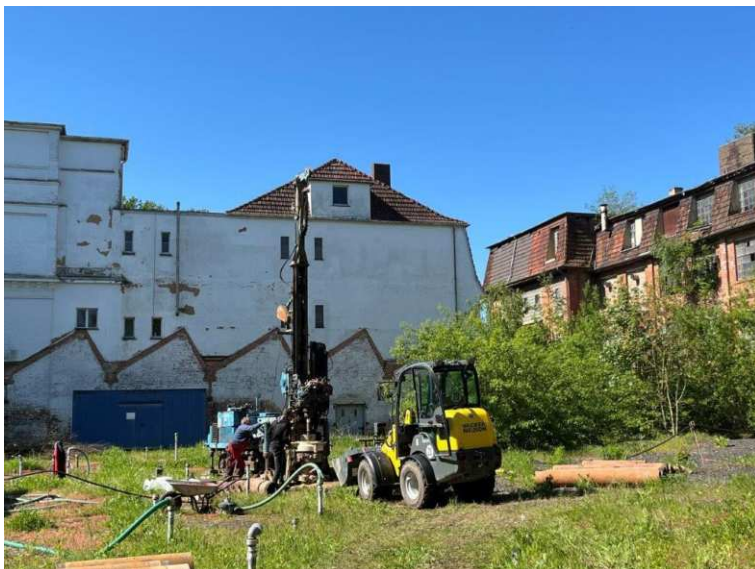
Bodenluftbrunnen auf ehem. Betriebsgelände
