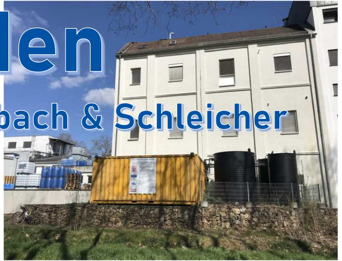
Wasseraufbereitungsanlage am Standort (momentan außer Betrieb)
