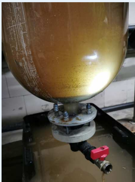
Schwerphasenabscheider mit LHKW in Phase
