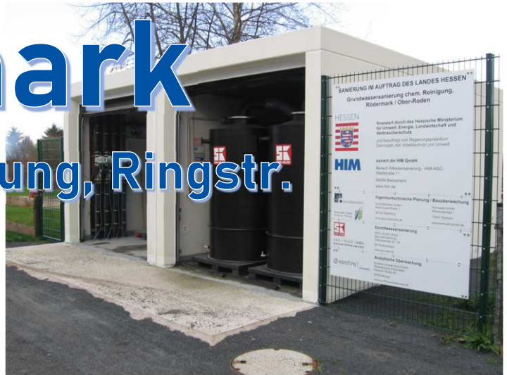
Grundwasserreinigungsanlage zur Abstomsicherung
