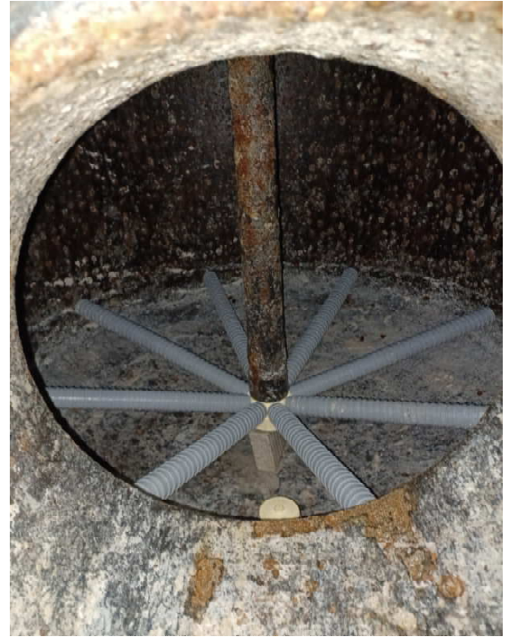
Adsorberbehälter mit Filterkerzen
