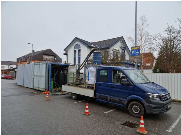
Wechsel von Luft-Aktivkohlefiltern bei Anlage „Mitte“
