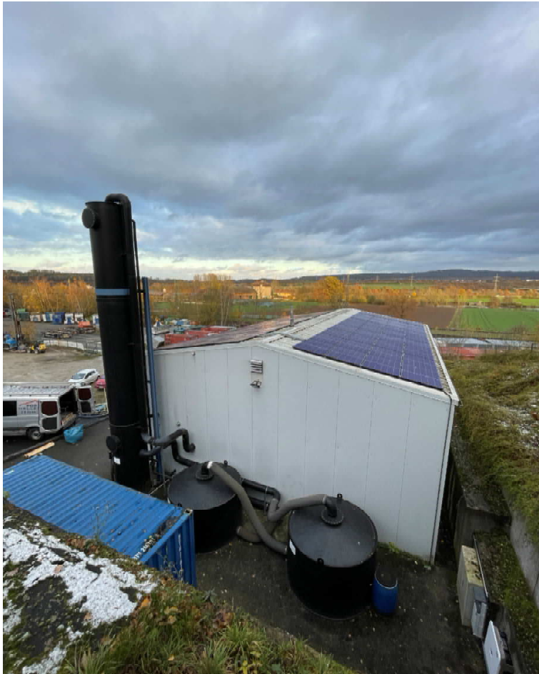
Sanierungsanlage nach Montage der Photovoltaikanlage
