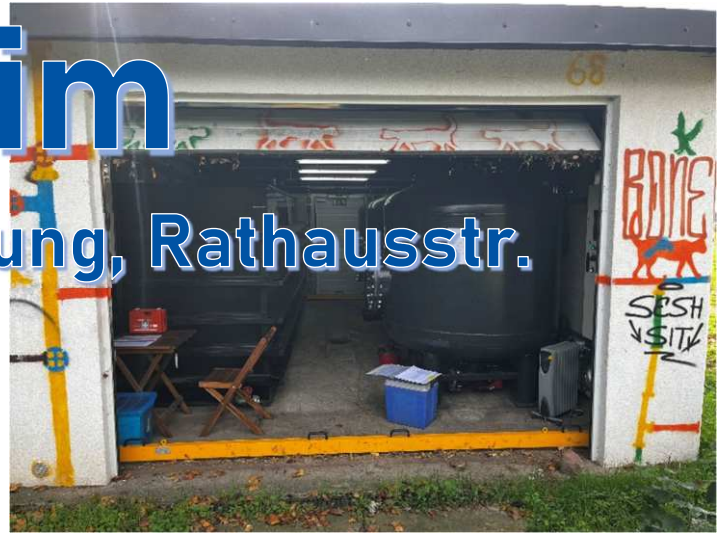
Wasseraufbereitungsanlage in einer Fertiggarage
