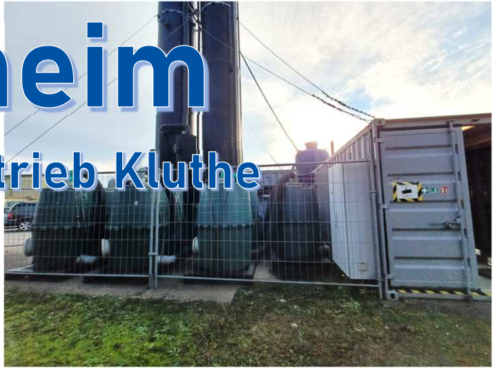
Grundwasserreinigungsanlage nach Umstellung auf eine zweite Luftaktivkohle-Einheit
