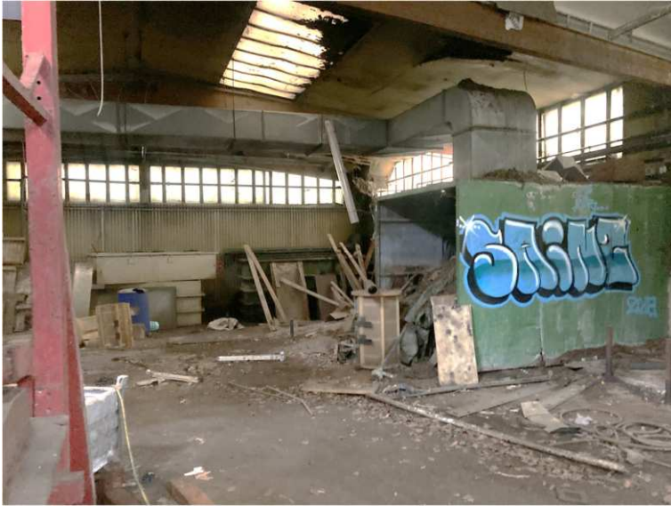
Alter Bauabschnitt mit PFAS-Belastungen im Eluat der Bausubstanz
