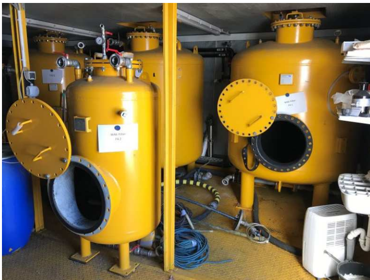
Entleerte Wasseraktivkohlefilter in der Wasseraufbereitungsanlage im „Stand-by“
