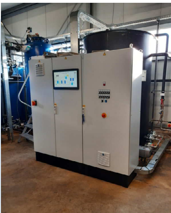
Neu errichteter Schaltschrank
