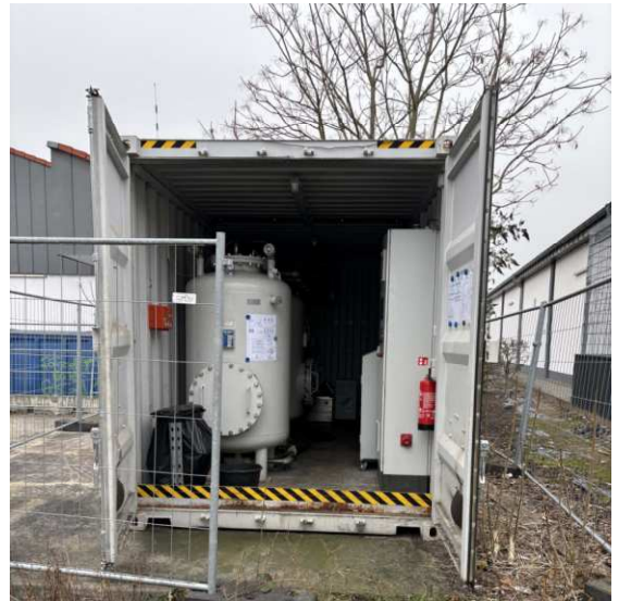
Anlage mit Sanierungsbrunnen
