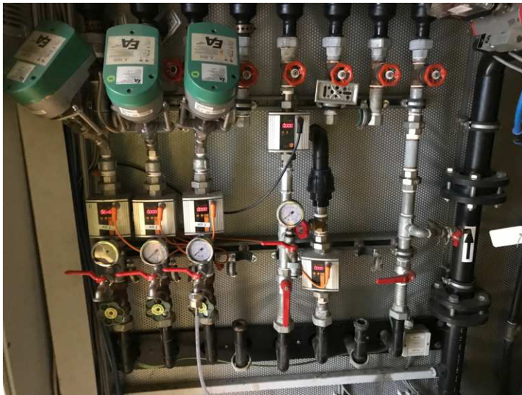
Leitungsstränge in der Wasseraufbereitungsanlage
