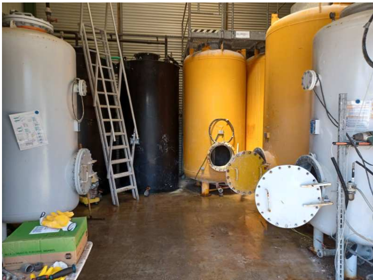
Innenansicht der Grundwassersanierungsanlage
