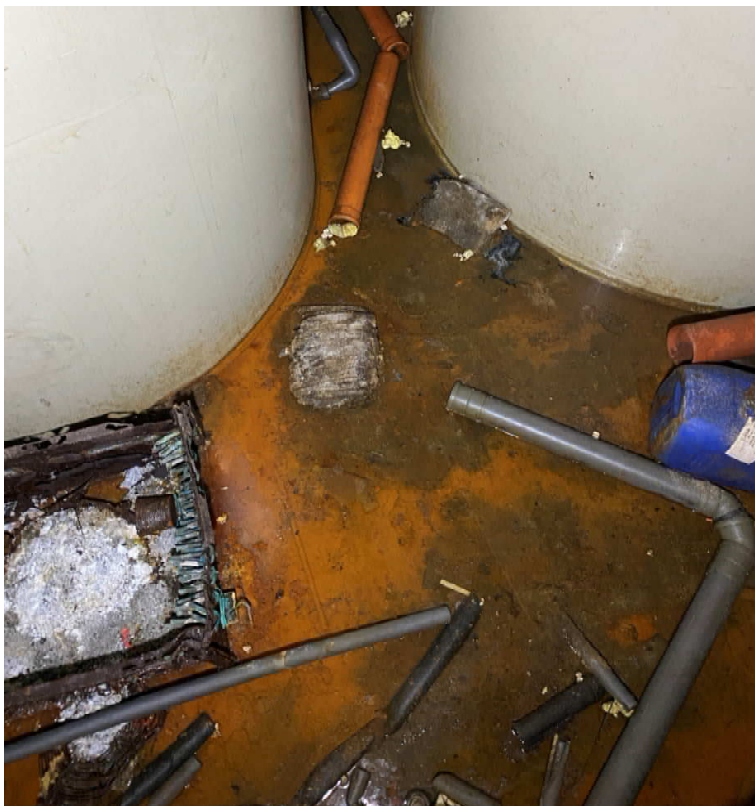
Schadstoffbelastetes Wasser im Keller der ehemaligen Wasseraufbereitung
