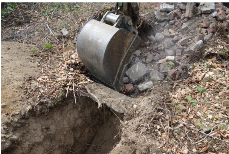
Mit Bauschutt verfülltes, ehemaliges Abwassergerinne
