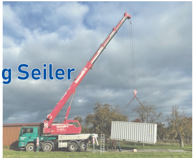
Aufstellung des Containers mit der Wasser- aufbereitungsanlage
