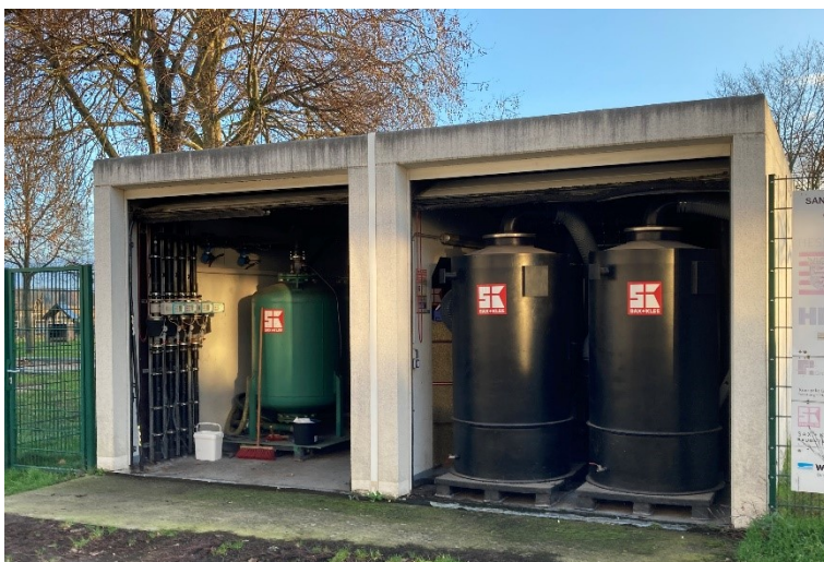
Grundwasserreinigungsanlage zur Abstromsicherung
