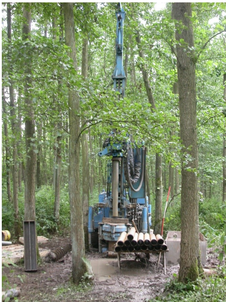
GW-Messstellenbau in der angrenzenden Flussaue
