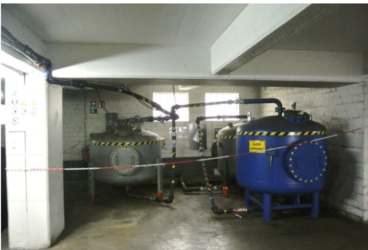
Grundwasserreinigungsanlage im Tiefgeschoss
