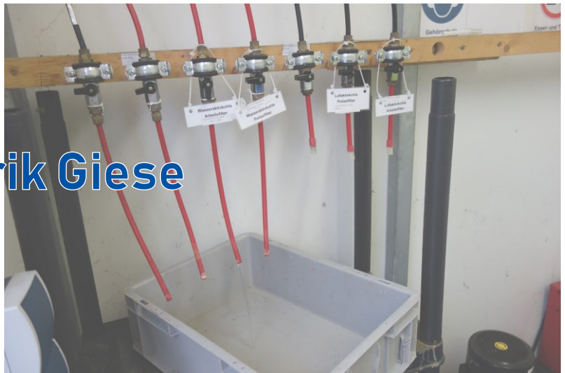
Zentrale Probenahme-Einrichtungen in der Wasseraufbereitungsanlage
