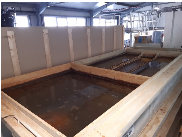
Sedimentation der Arsenbelastungen (Makroflocken) in einem Schrägklärer
