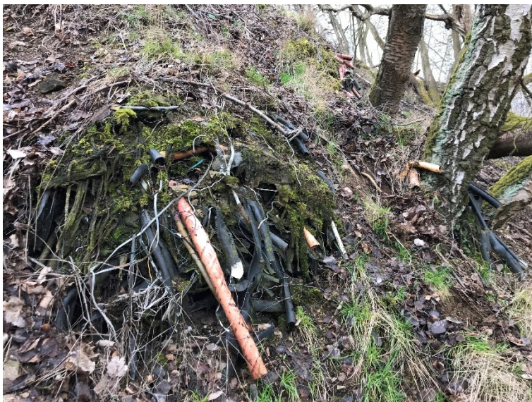
Kabelummantelungen in der geschütteten Böschung
