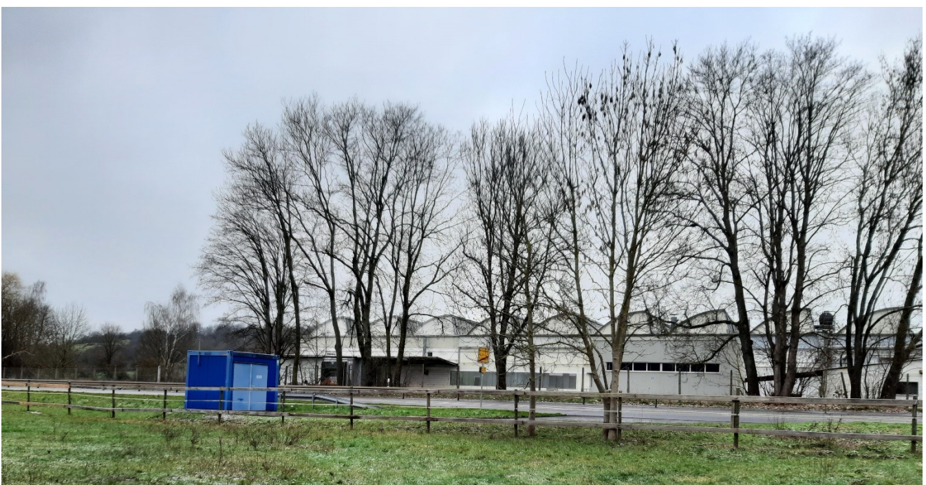
Container mit Teerölabsaugung an der B 455
