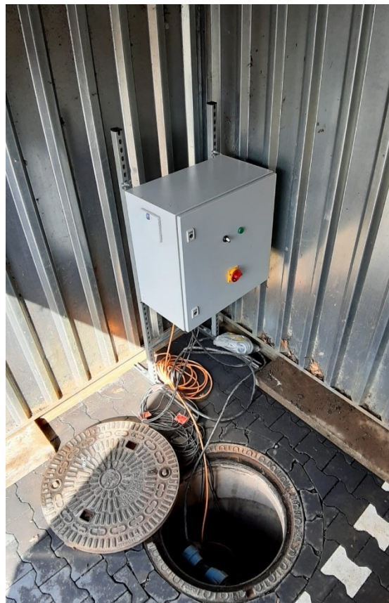
Einrichtungen zur Durchführung eines Pumpversuchs an GWM 106
