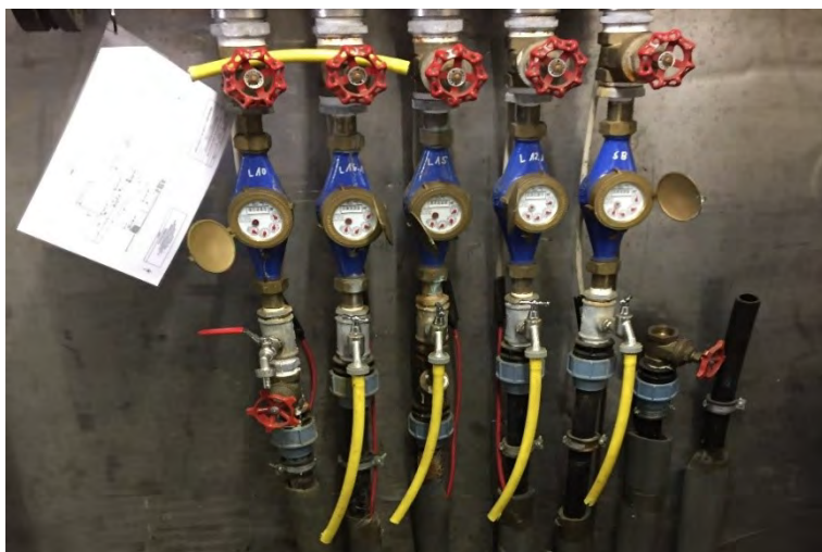
Rohwasserzuleitungen in der GWRA mit Probenahmeventilen zur Probenahme
