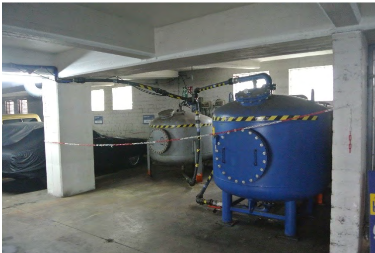
Grundwasserreinigungsanlage im Tiefgeschoss
