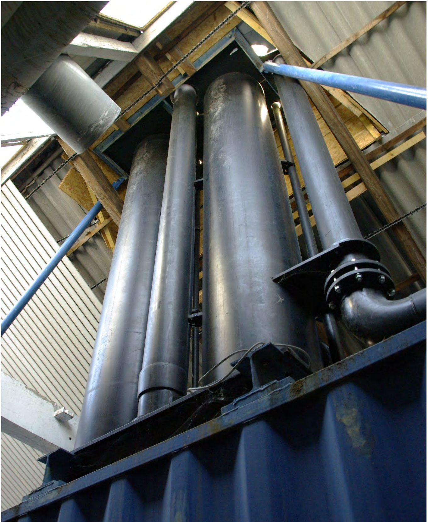
Striptürme der Grundwassersanierungsanlage
