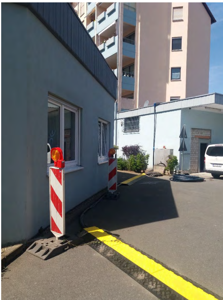
Leitungsführung Pumpversuch GWM 22
