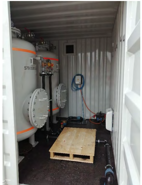
Mobile Wasseraufbereitungsanlage (WAA) für den Pumpversuch
