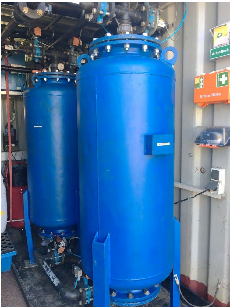
Blick in die Sanierungsanlage mit Kiesfiltern
