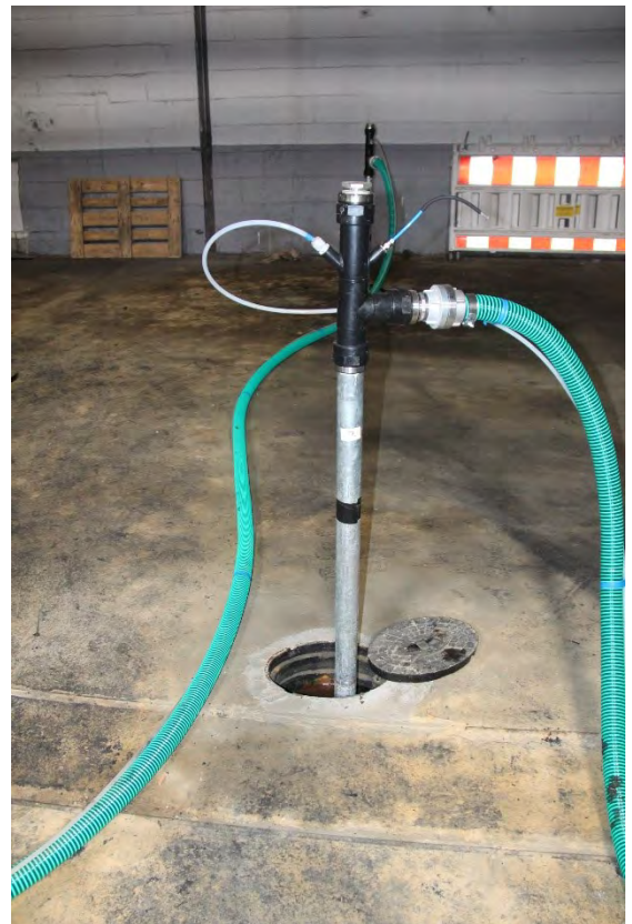
Bodenluft-Absaugpegel im Werksbereich
