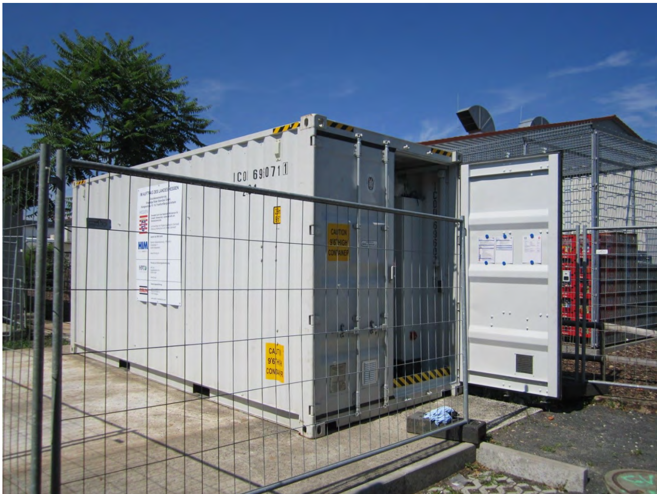
Container mit der Sanierungstechnik zur Grundwasserförderung aus dem Eintragsbereich
