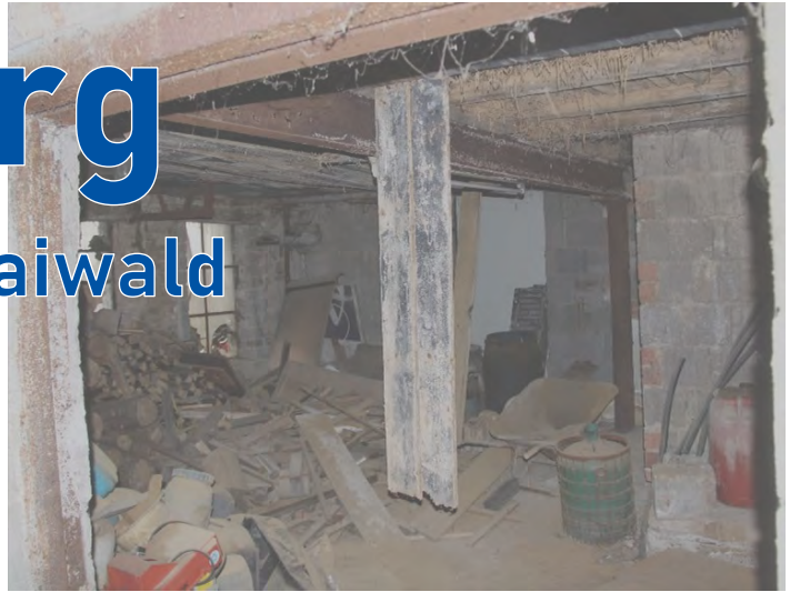
Einsturzgefährdete, ehemalige Produktions- und Lagerräume
