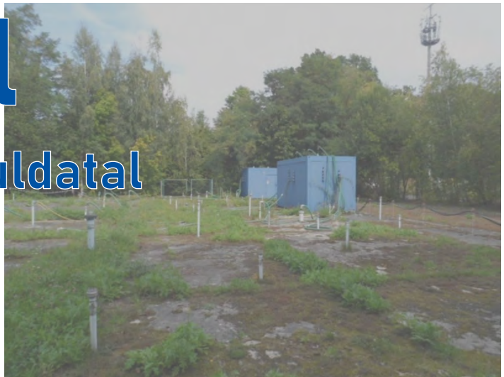
Ehem. Betriebsgelände mit Bodenluftabsaug- und Air-Sparging-Anlage
