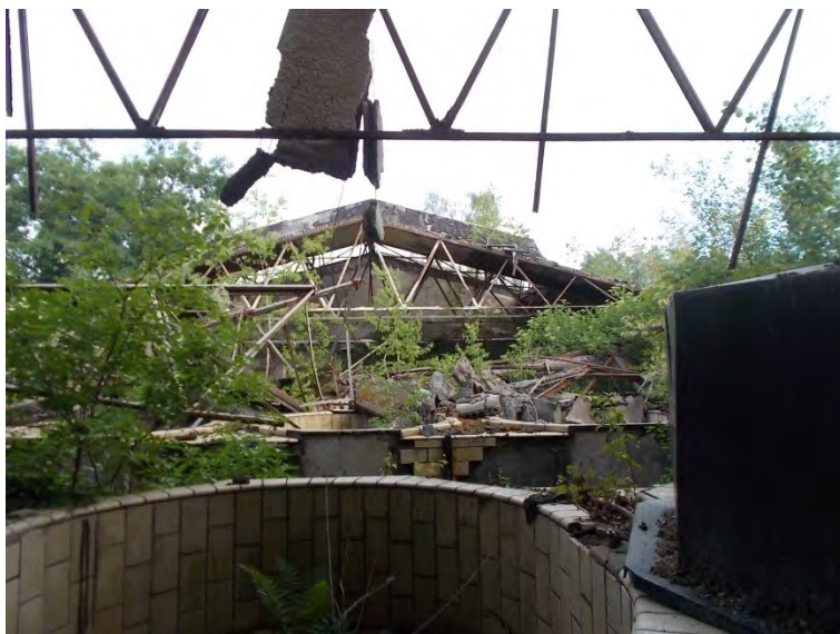
Blick über eingestürzten, zentralen Bereich des rückzubauenden Gebäudetrakts
