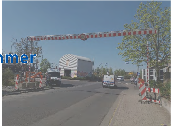
Leitungsbrücke Pumpversuch GWM 22 und GWSA
