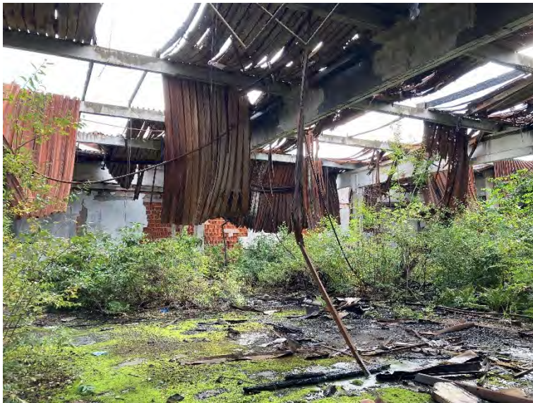
Brand- und Verwitterungsschäden der Halle des Werk II
