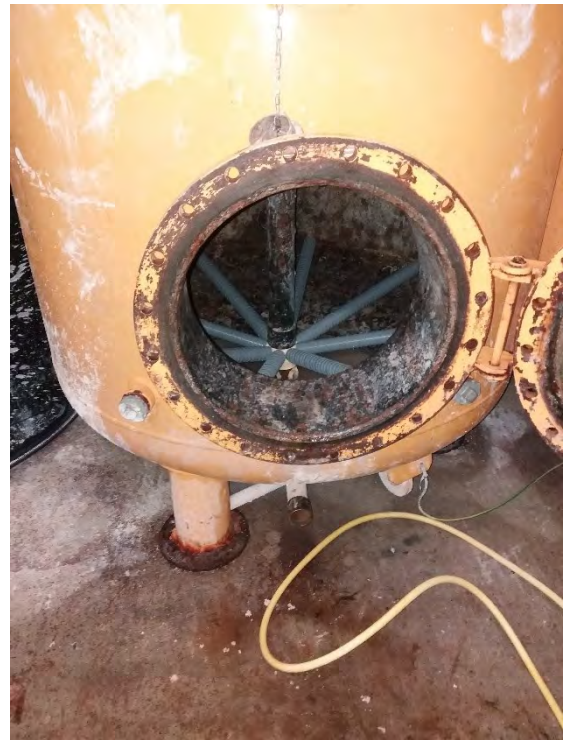
Adsorberbehälter mit Filterkerzen
