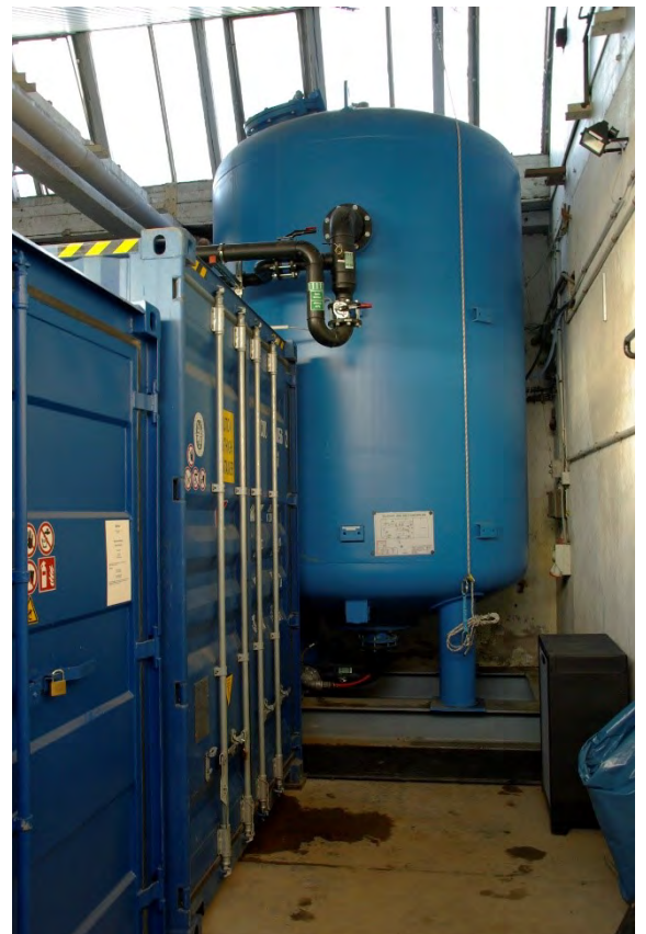
Wasseraktivkohle-Behälter der Grundwassersanierungsanlage
