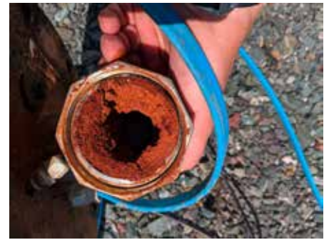
Eisenablagerung in der Leitung
