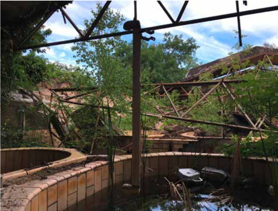
Beckeneinbauten und eingestürztes Dach der neuen Wasserwerkstatt
