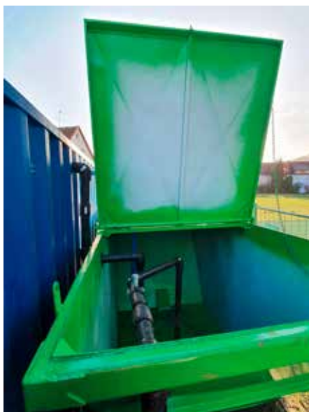
Erneuerte Grundwasserreinigungsanlage 2019: neue Reinwassermulde
