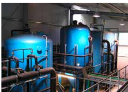
Sanierungsanlagen der HIM-ASG
