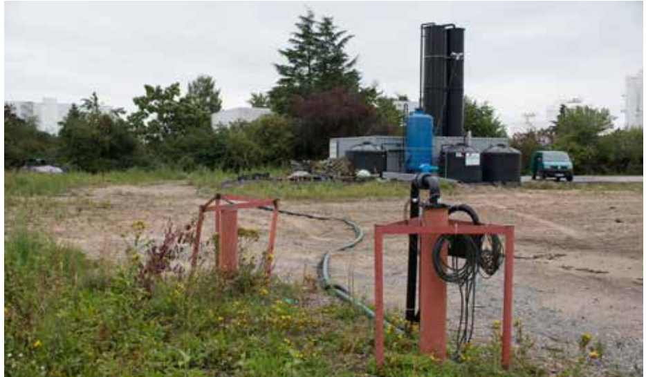
Grundwasserreinigungsanlage auf dem Sanierungsgelände
