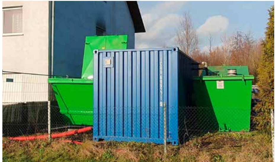
Erneuerte Grundwasserreinigungsanlage 2019 auf dem Gelände der ehem. Metallverarbeitung Petri KG: neuer Anlagencontainer und Reinwassermulde
