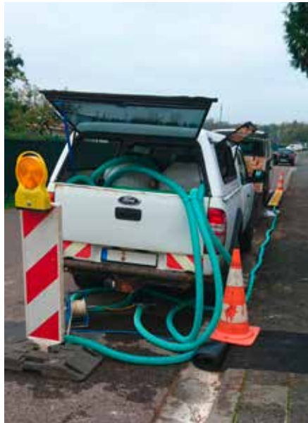
Mobile Wasseraufbereitungsanlage, Pumpversuch 2019
