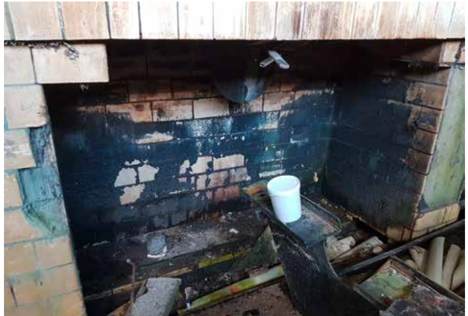
Mit Schwermetallen verunreinigte Bausubstanz
