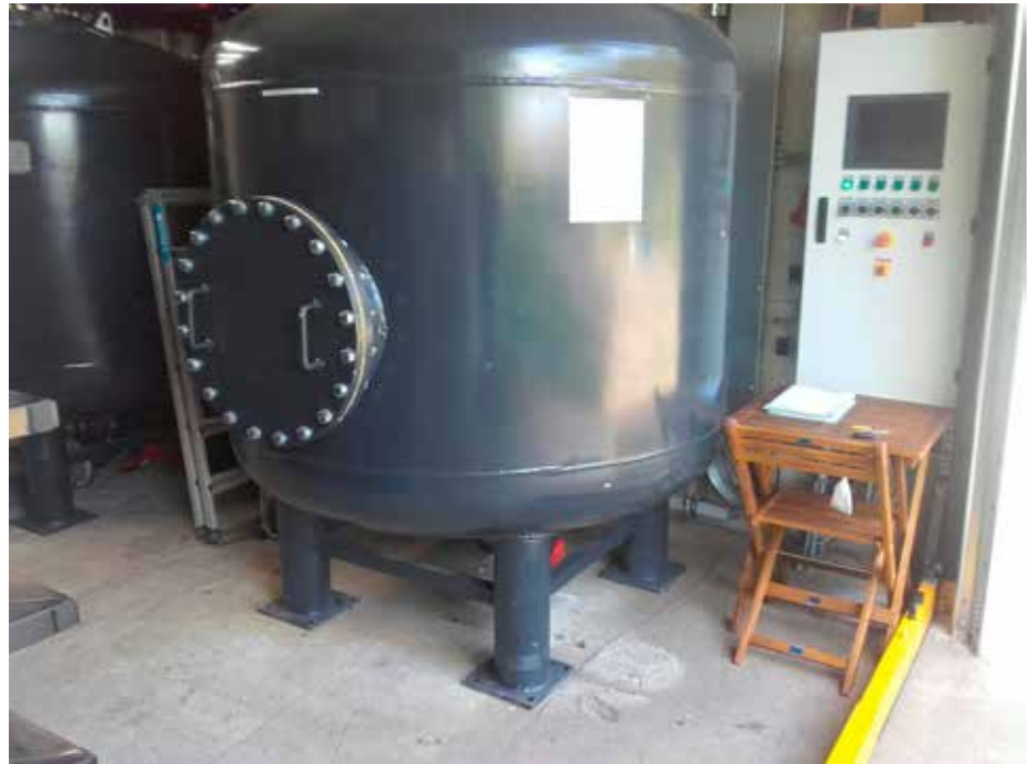
Blick in die Wasseraufbereitungsanlage
