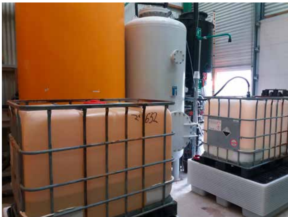
Säuredosierung in der Aufbereitungsanlage
