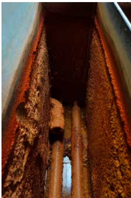
Eisenschlammablagerung im Horizontalstripper (vor Wartung)
