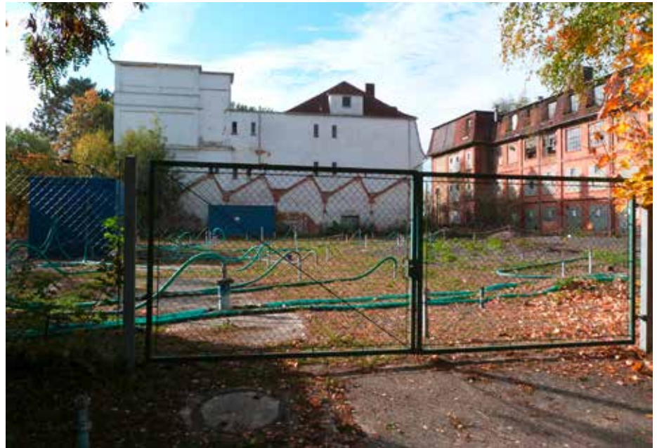
ehem. Betriebsgelände mit Bodenluftabsaug- und Air Sparging-Anlage
