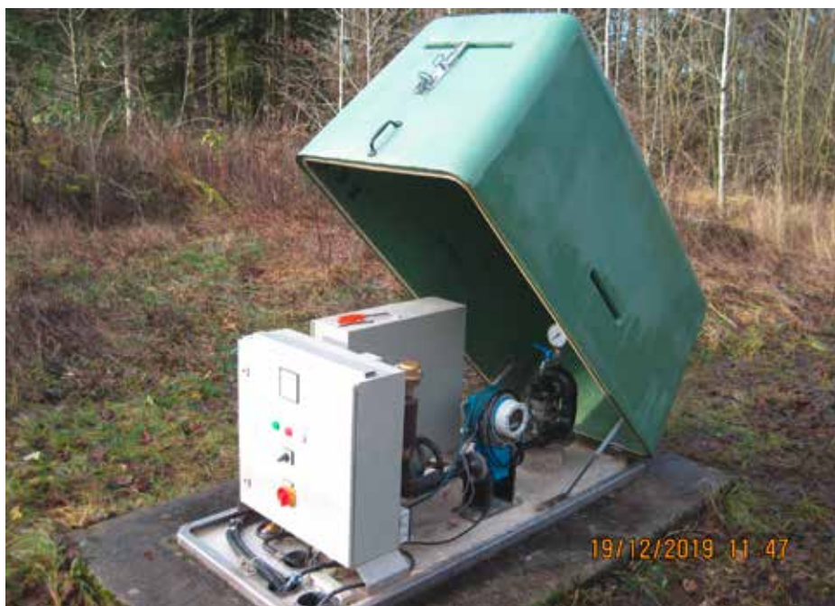
Fördereinrichtung BR 53 bei geöffneter Brechtel-Haube
