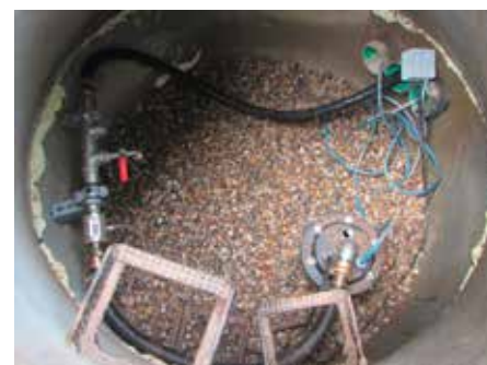
Blick in den neuen Sanierungsbrunnen
