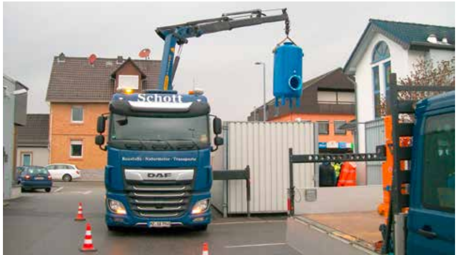
Anlieferung erneuerter Wasseraktivkohlefilter
