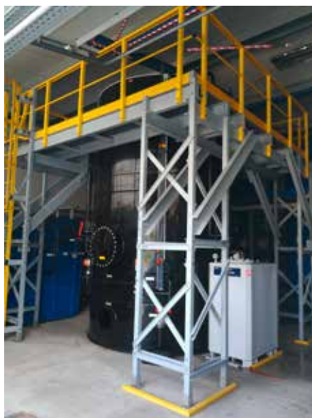
Vertikalölabscheider mit Arbeitspodest und Leichtölphasensammeltank
