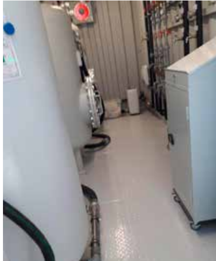
Blick in die neue Sanierungsanlage
