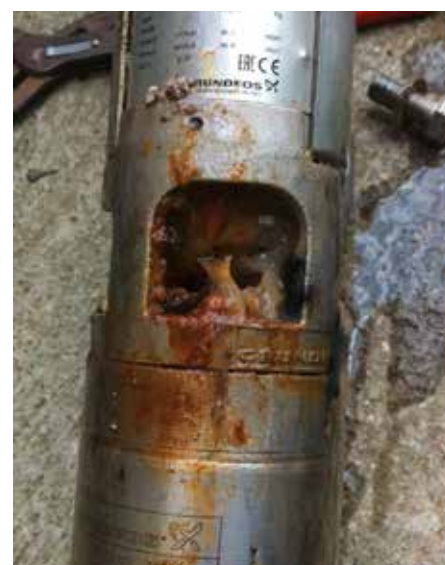
Biofouling an einer Brunnenpumpe
