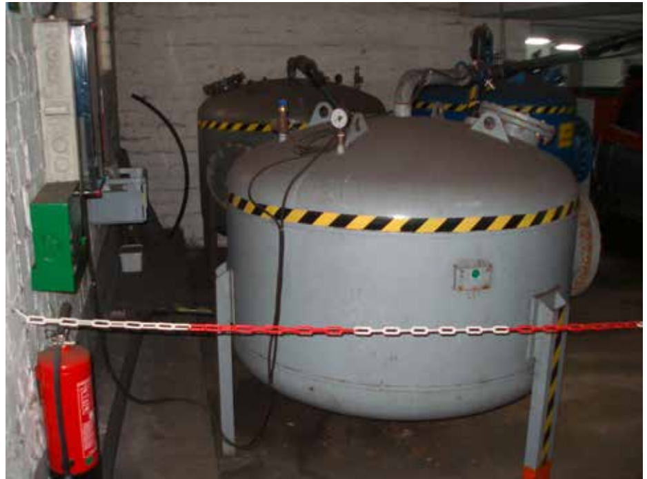
Filtereinheiten der Sanierungsanlage
