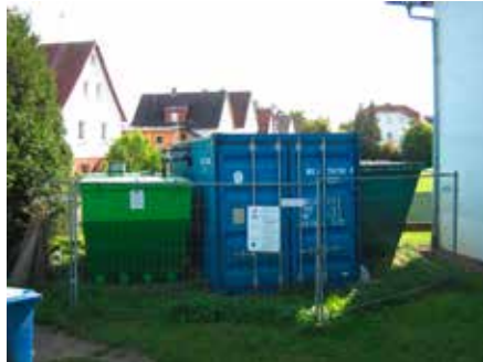
Standort der Sanierungsanlage
