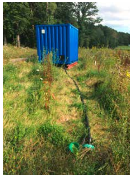
Vakuumanlage in der Kleinniederung
