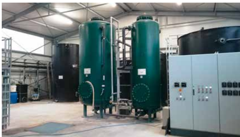
Wasseraufbereitungsanlage für die hydraulische Sicherung
