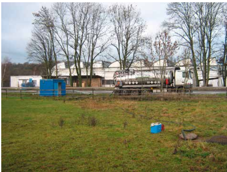
Teerölabsaugung (Schwerphase) aus Sanierungsbrunnen „C“
