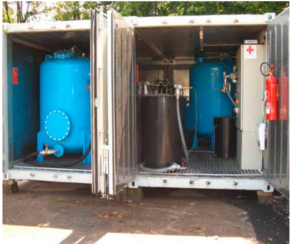
Blick in die Sanierungsanlage
