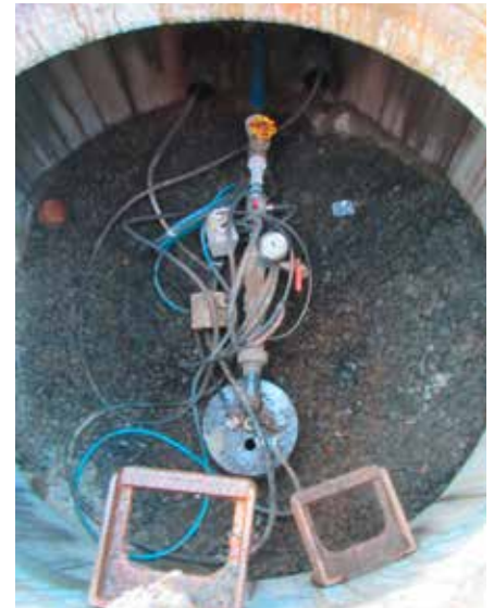
Blick in einen Sanierungsbrunnen
