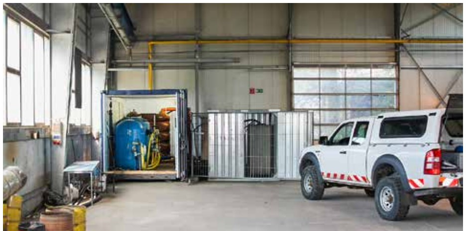
Wasseraufbereitungsanlage in einer Werkhalle
