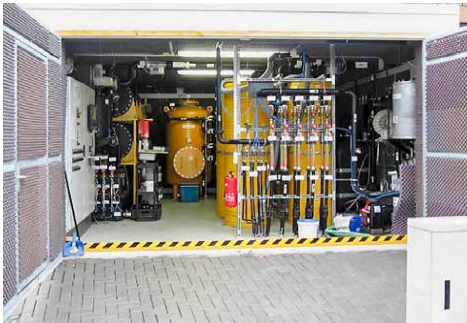
kombinierte Bodenluft-, Schicht- und Grundwasseranierungsanlage
