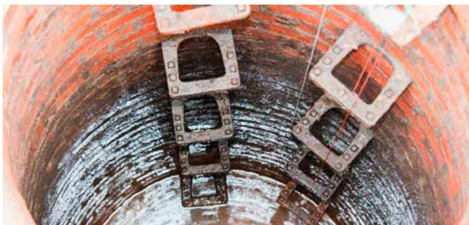
Kanal-Schachtbauwerk mit Öl-Verunreinigungen aus der Vergangenheit
