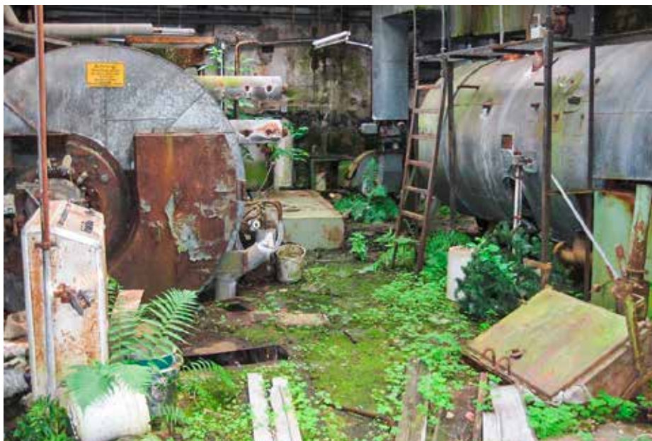
zunehmender Verfall der Betriebsgebäude
