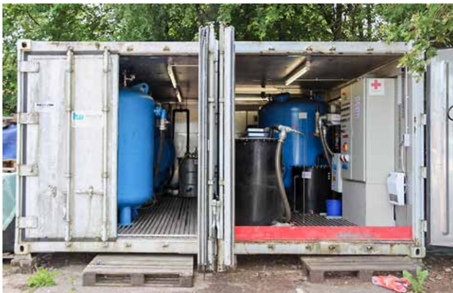
Sanierungsanlage für Grundwasser und Bodenluft
