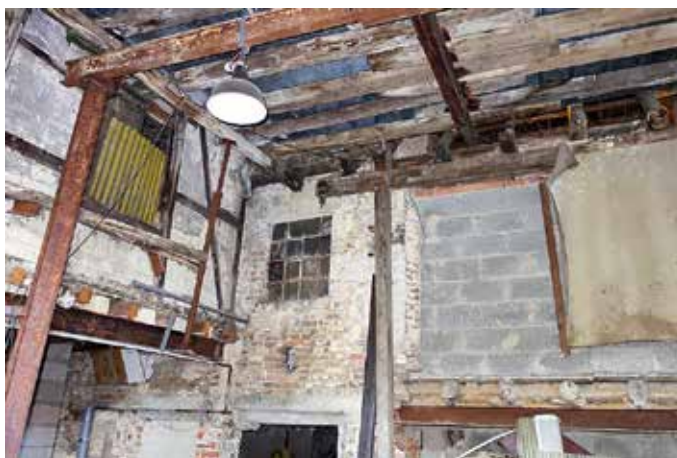
baufälliger ehemaliger Betriebsraum
