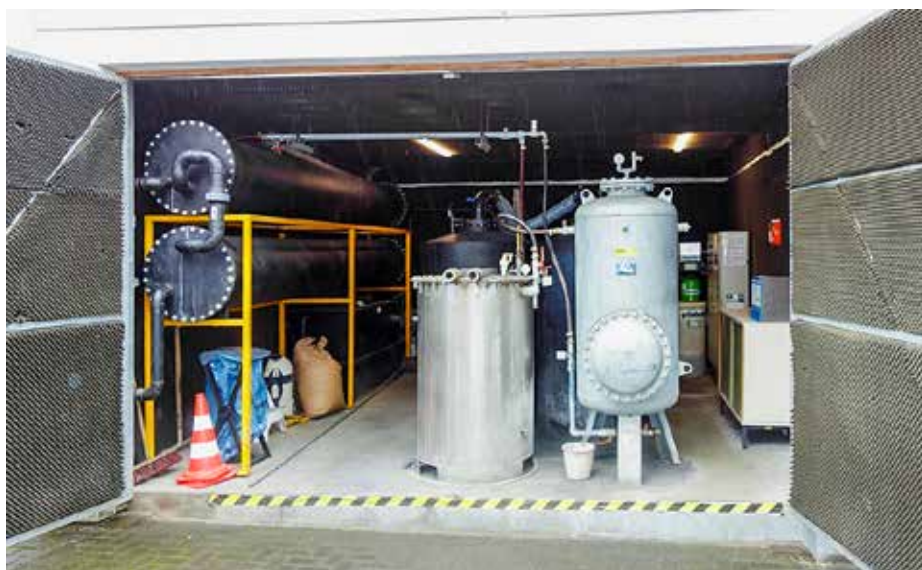
Blick in die Wasseraufbereitungsanlage
