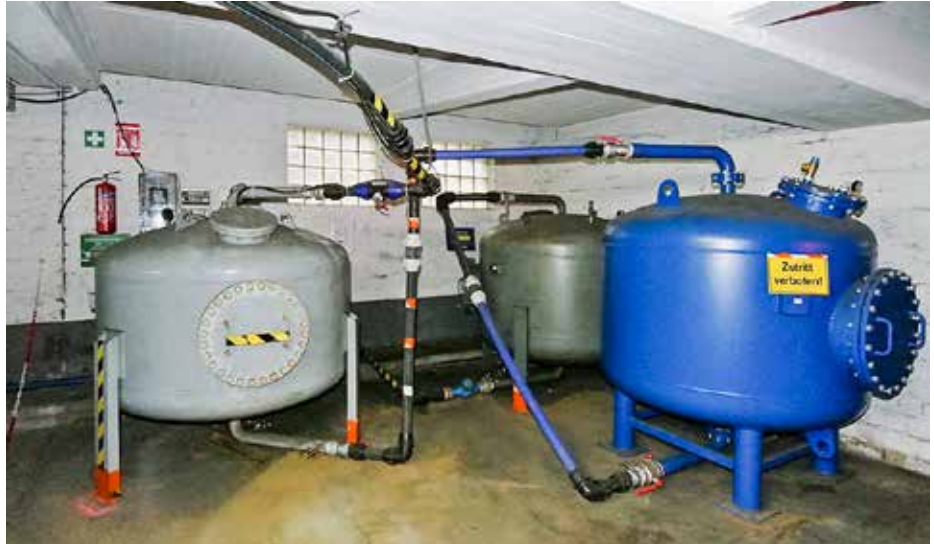
Sanierungsanlage im Untergeschoss Parkhaus Selterstor (ehem. FINA-Parkhaus)
