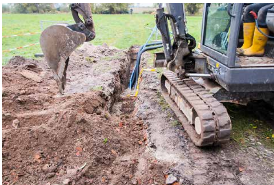
Anschluss Sanierungsbrunnen SB6
