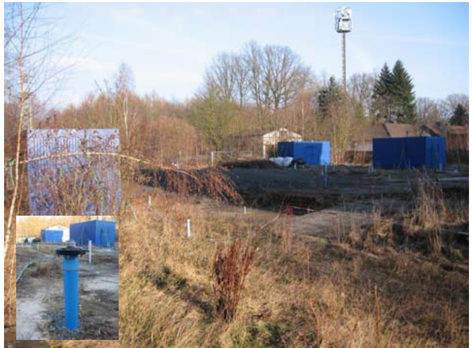
Ehem. Betriebsgelände: Bodenluftabsaugpegel mit Bodenluftsanierungsanlagen
