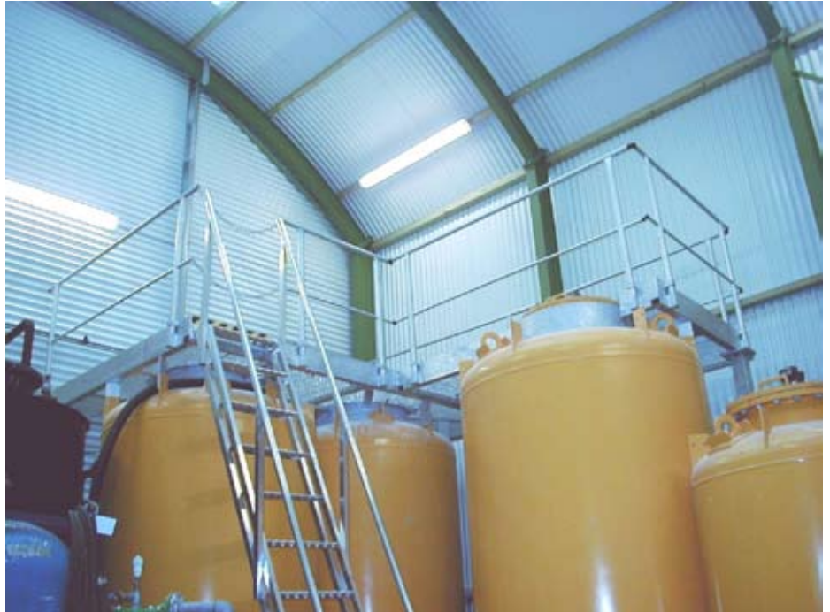
Innenansicht der Sanierungsanlage
