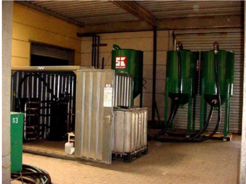
Blick auf die Air Sparging-Anlage
