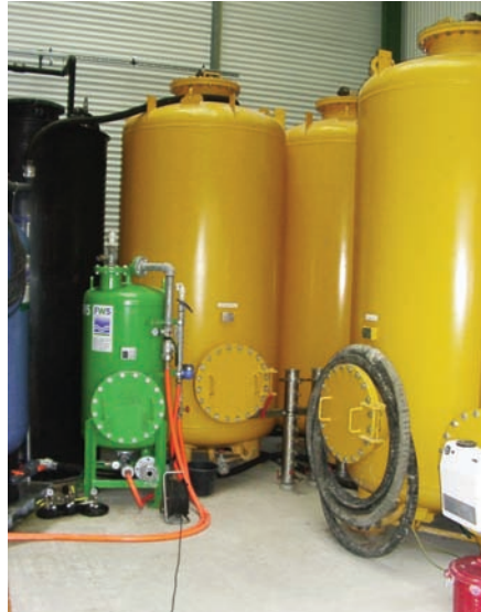
Innenansicht der Sanierungsanlage
