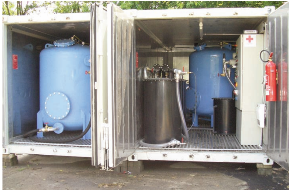
Blick in die Doppelcontainer der Sanierungsanlage
