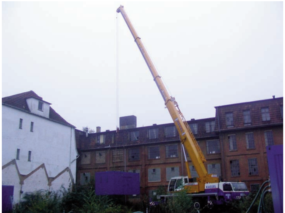
Umsetzen der Bodenluftabsauganlage
