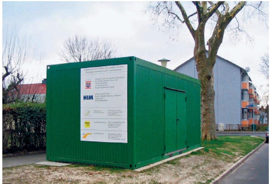
Sanierungsanlage für die Schadstofffahne
